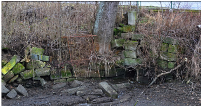
Snímek z 27.1.2016 ukazuje na havarijný stav opěrné zdi v místě zaústění přítokového potrubí do rybníčku. (Foto a text J. Pražan)
