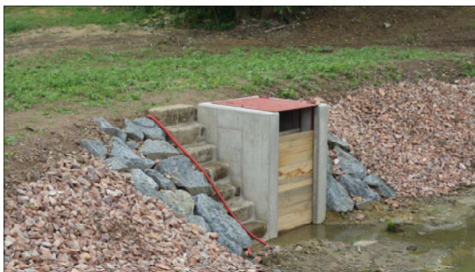
Snímek nového stavidla.
