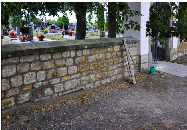
Na snímku z 20.8. 2016 je vidět částečně opravená pískovcová zeď přiléhající ke vstupu na bítovanský hřbitov.
