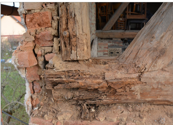
Snímek 20.11.2017 dokládá havarijní stav severozápadního nároží budovy hasičské zbrojnice. Staticky bylo nároží zajištěno ocelovými táhly a armovaným betonovým věncem. Náhrada ztrouchnivělých částí vazby bude provedena v druhé etapě rekonstrukce v r. 2018.
